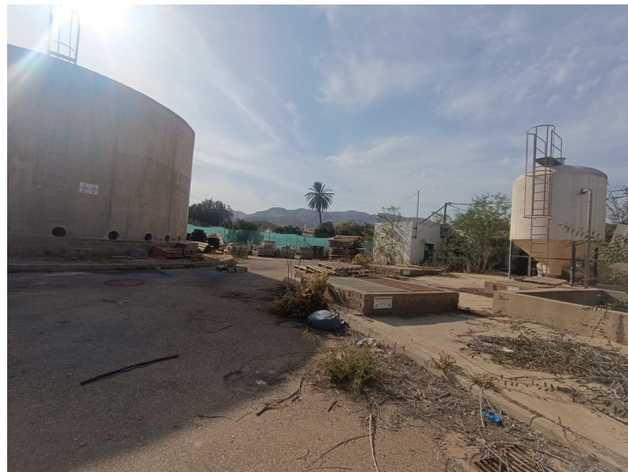
EDAR Estación Depuradora DS. CM Pechina
