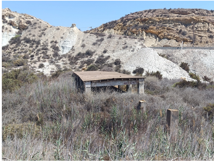
Lavadero El Chuche
