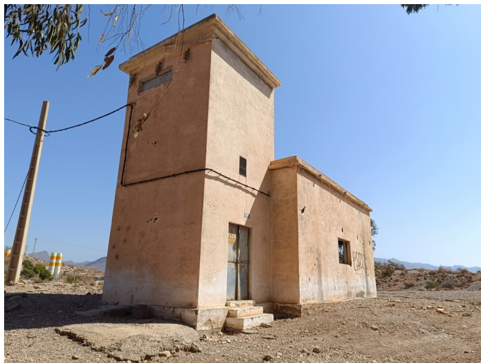
Transformador eléctrico DS La Viña
