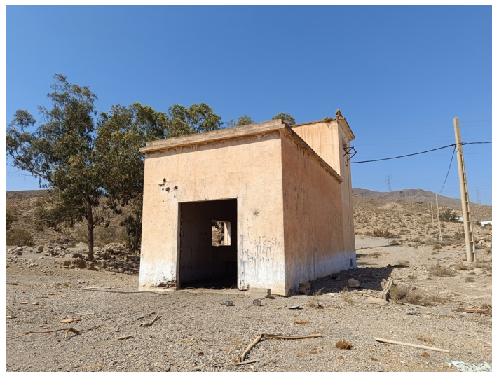
Transformador eléctrico DS La Viña
