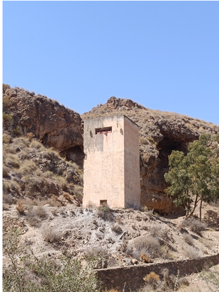
Terreno Transformador eléctrico DS La Viña 4
